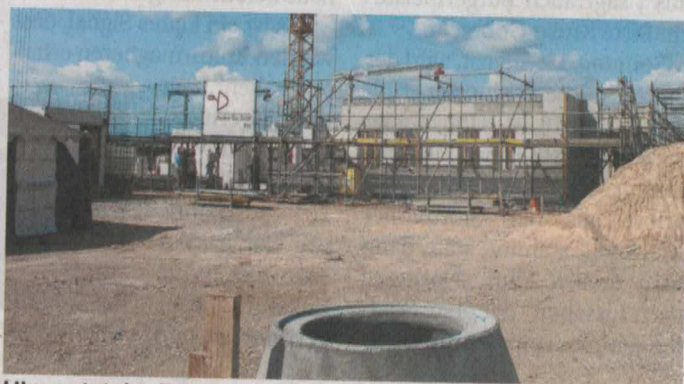
Hier entsteht die neue Kita Braak, die im nächsten August in Betrieb genommen wird.
